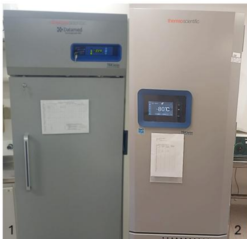
(1) Freezer -30°C (Thermo TSX/659L) patrimônio em processo; (2) Ultrafreezer -80°C (Thermo Tsx/549L), Pat.S-42632686.
